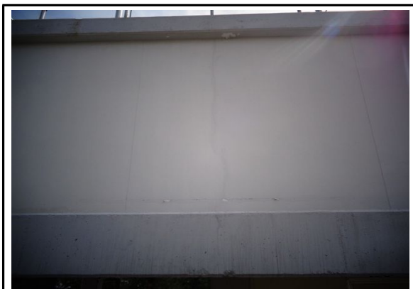
벽체 폭 0.3mm미만 균열
