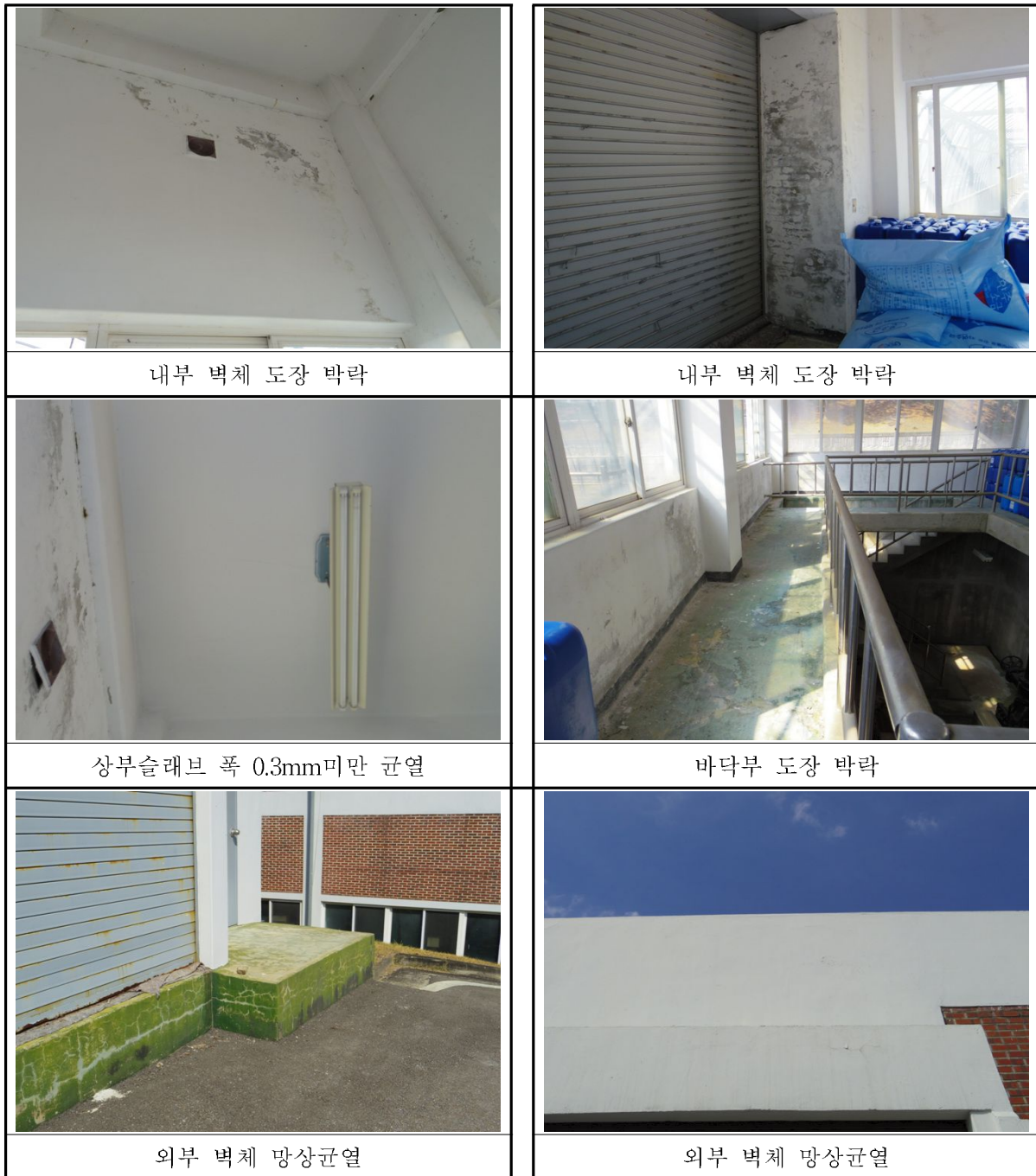
【사진 3.102】 배출수지펌프동 손상현황 (계속)
