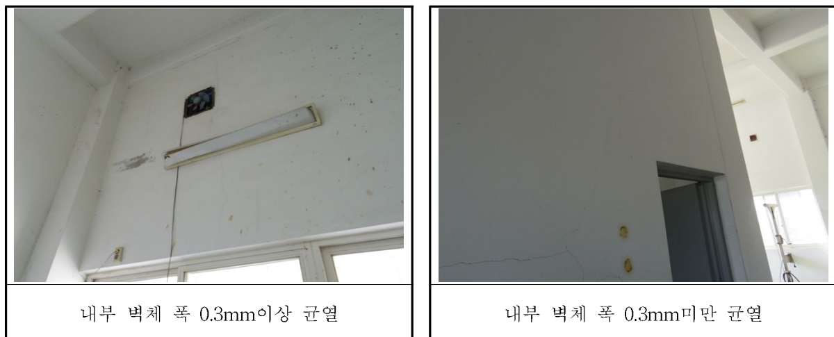
【사진 3.92】 탈수기동 손상현황
