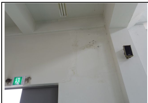
내부 벽체 폭 0.3mm미만 균열
