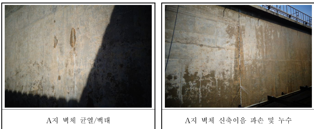
【사진 3.8】 침전지 손상현황
