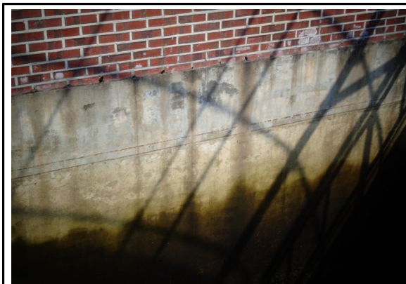
A지 벽체 망상균열
