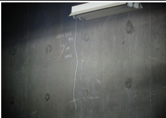
벽체 폭 0.3mm미만 균열
