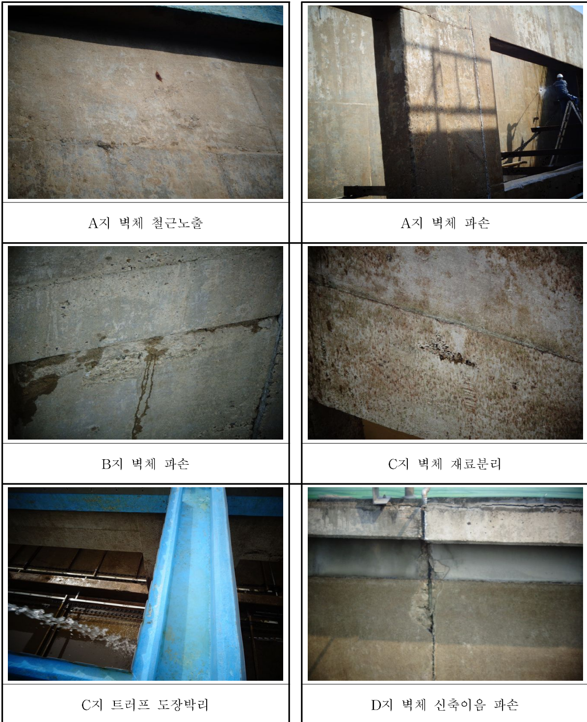
【사진 3.8】 침전지 손상현황 (계속)
