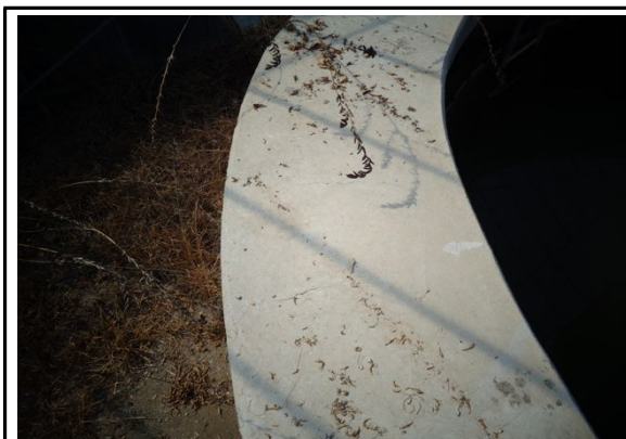
벽체 폭 0.3mm미만 균열
