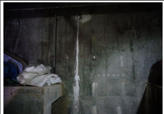
구동기실 #2 벽체 균열/백태
