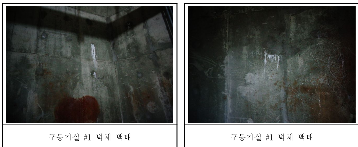
【사진 3.6】 응집지 손상현황
