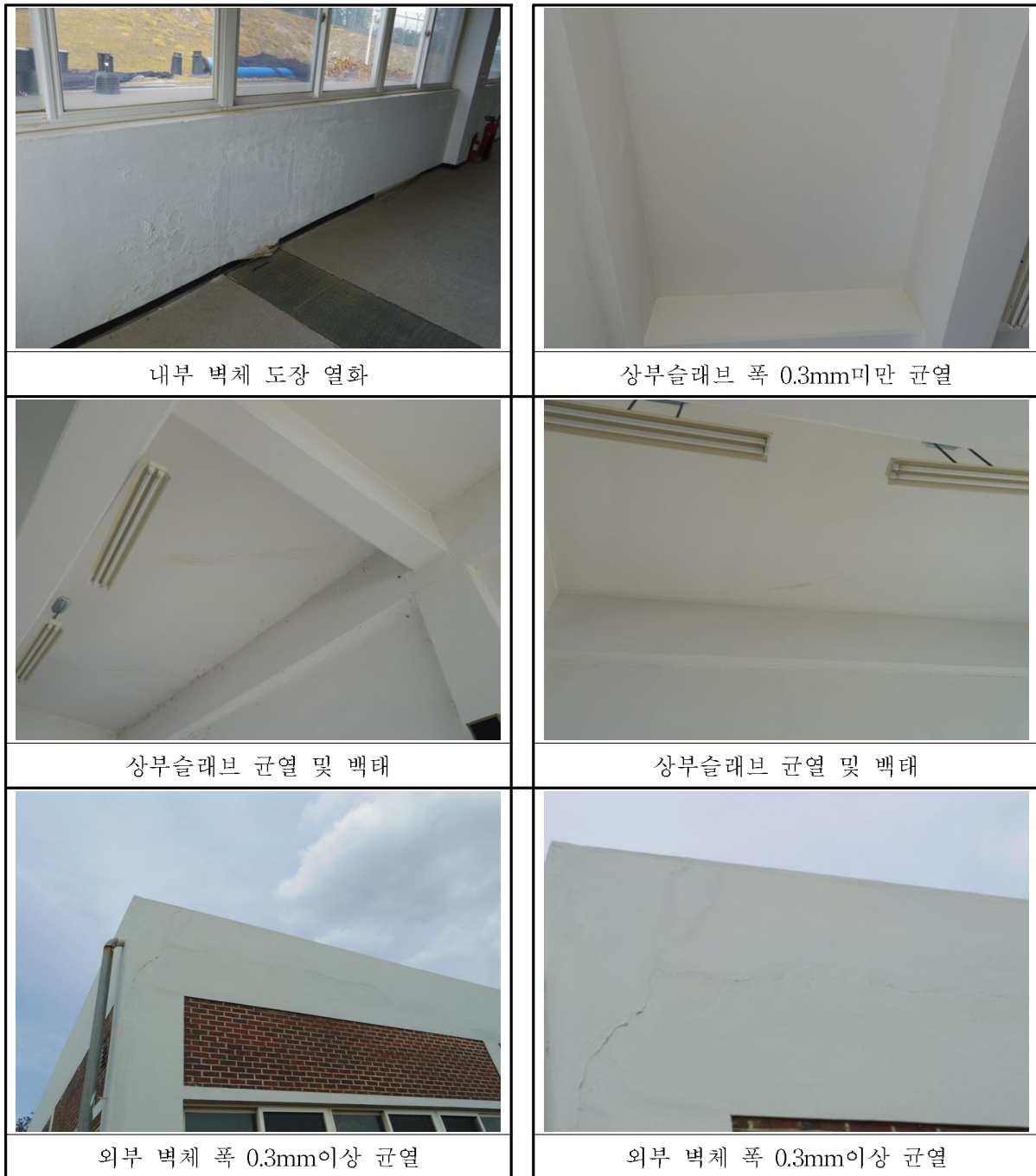
【사진 3.98】 변전실동 손상현황 (계속)
