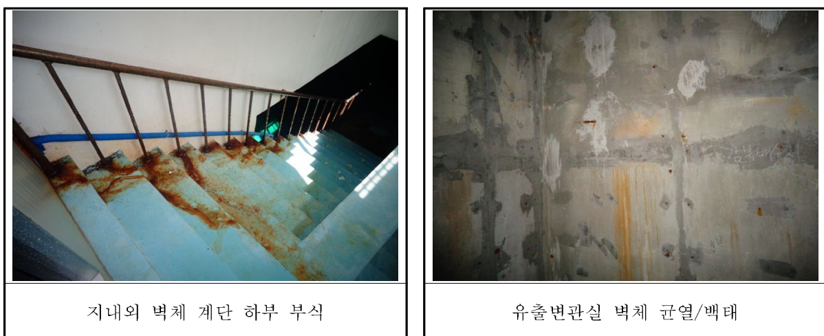
【사진 3.36】 강북배수지 손상현황
