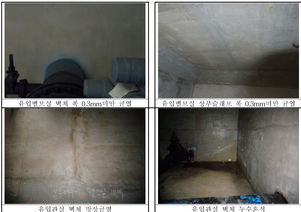
【사진 3.32】 본두배수지 손상현황
