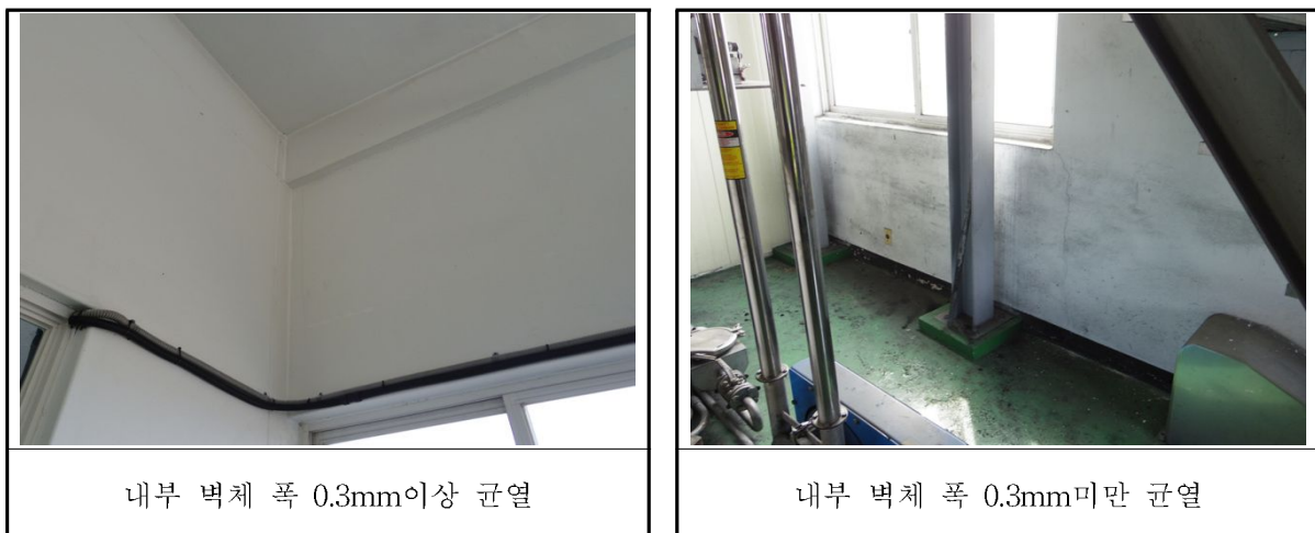
【사진 3.94】 약품투입동 손상현황
