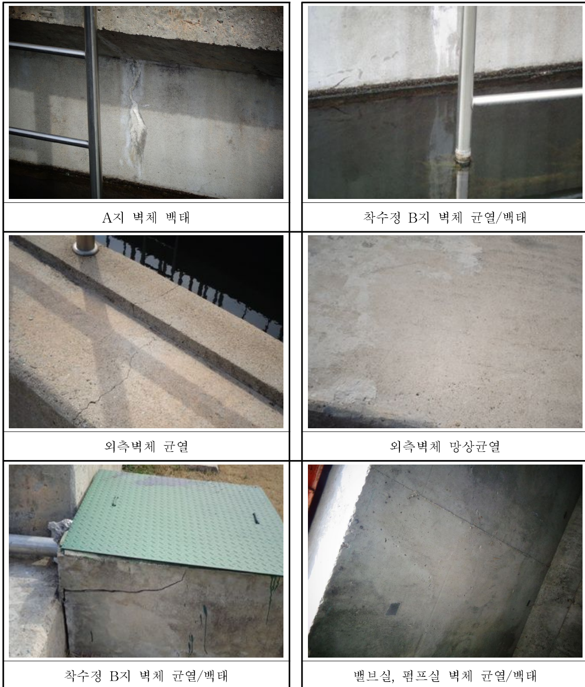
【사진 3.2】 착수정 손상현황
