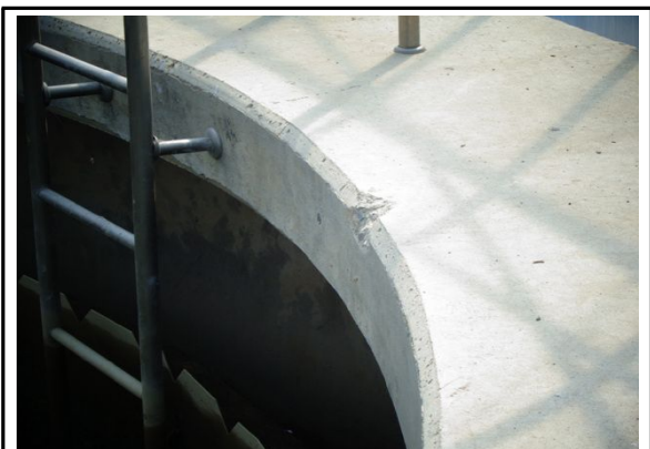
벽체 콘크리트 파손
