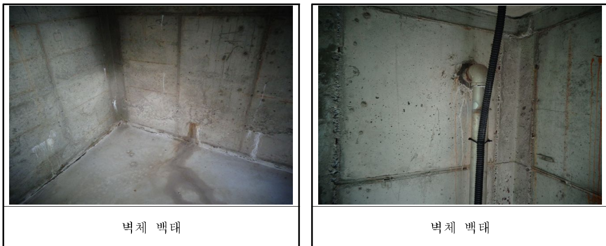
【사진 3.86】 점봉동 가압장 손상현황
