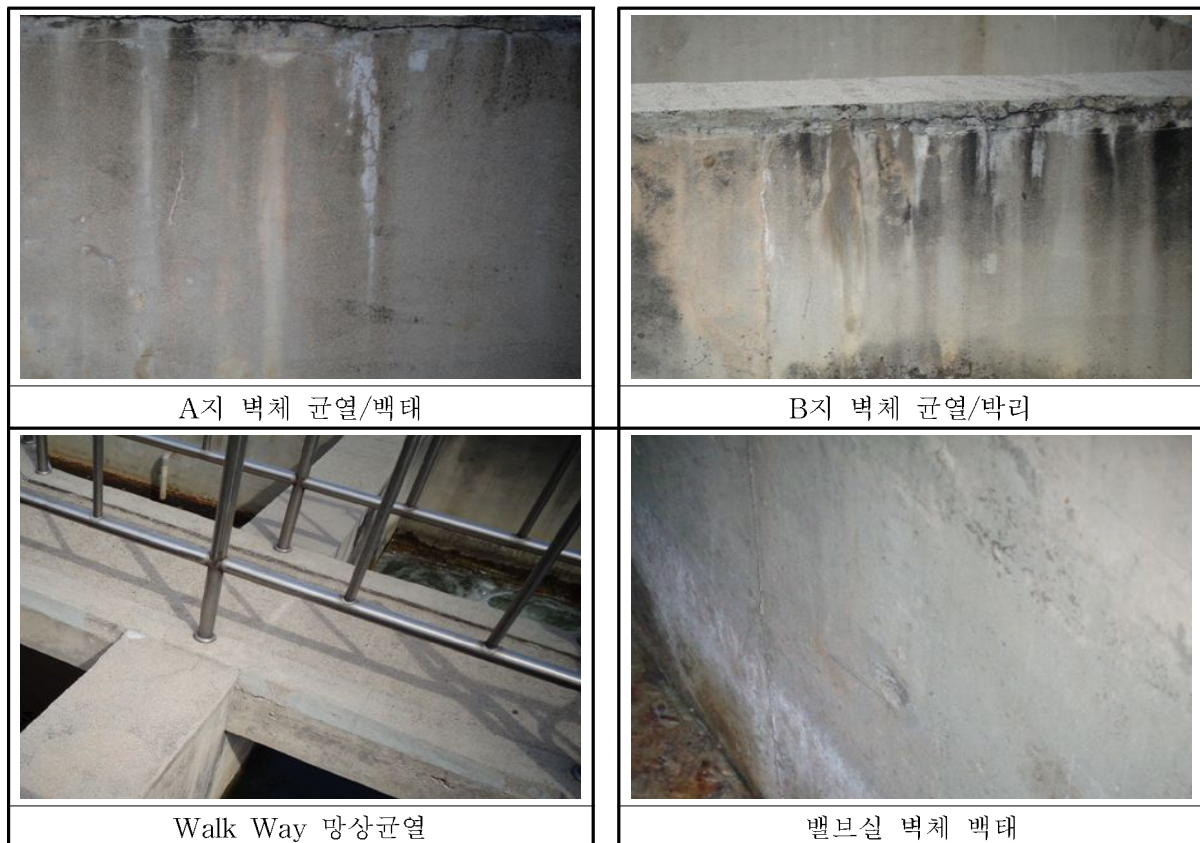
【사진 3.4】 혼화지 손상현황
