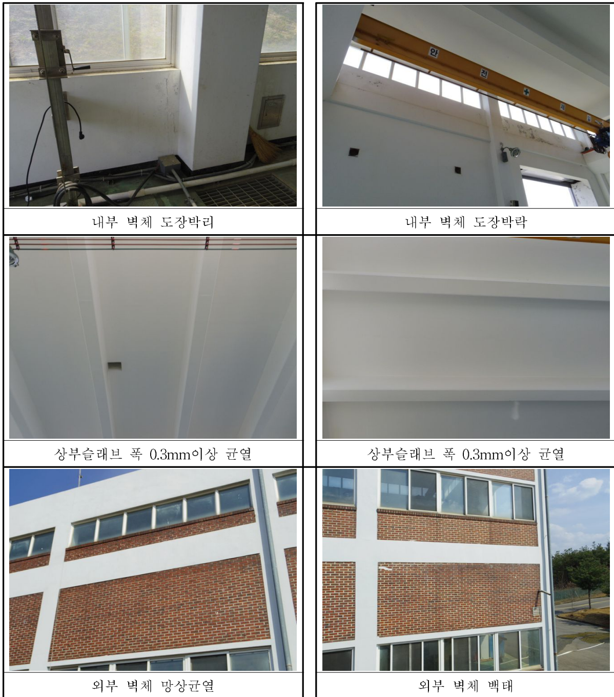
【사진 3.92】 탈수기동 손상현황 (계속)
