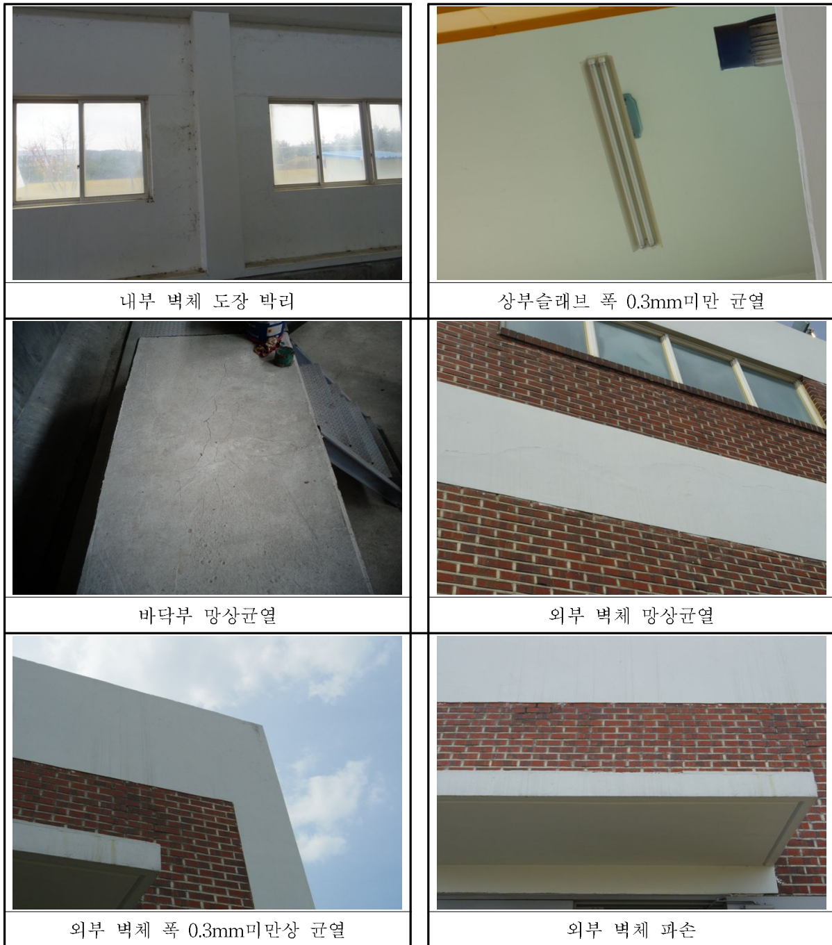
【사진 3.100】 송수펌프동 손상현황 (계속)
