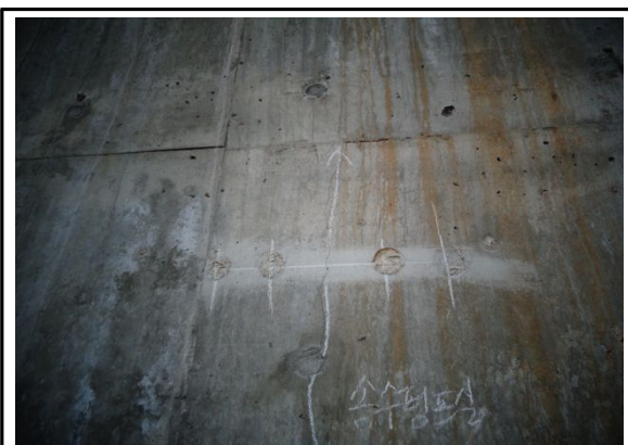
벽체 폭 0.3mm이상 균열
