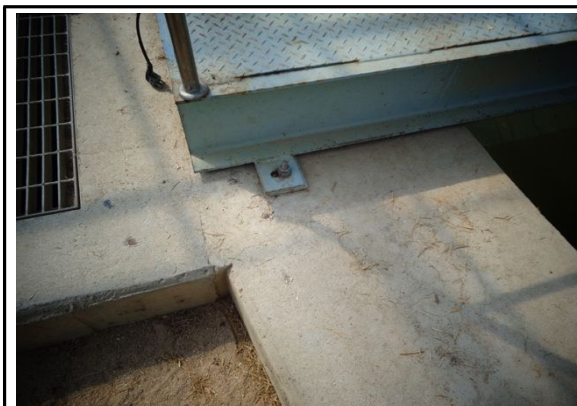
벽체 폭 0.3mm미만 균열
