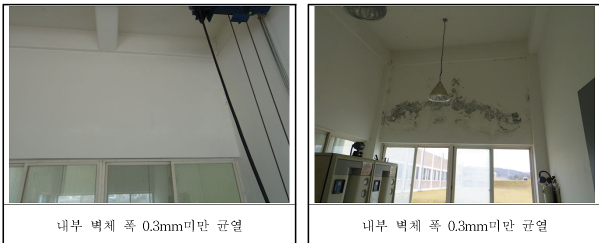
【사진 3.96】 염소투입동 손상현황
