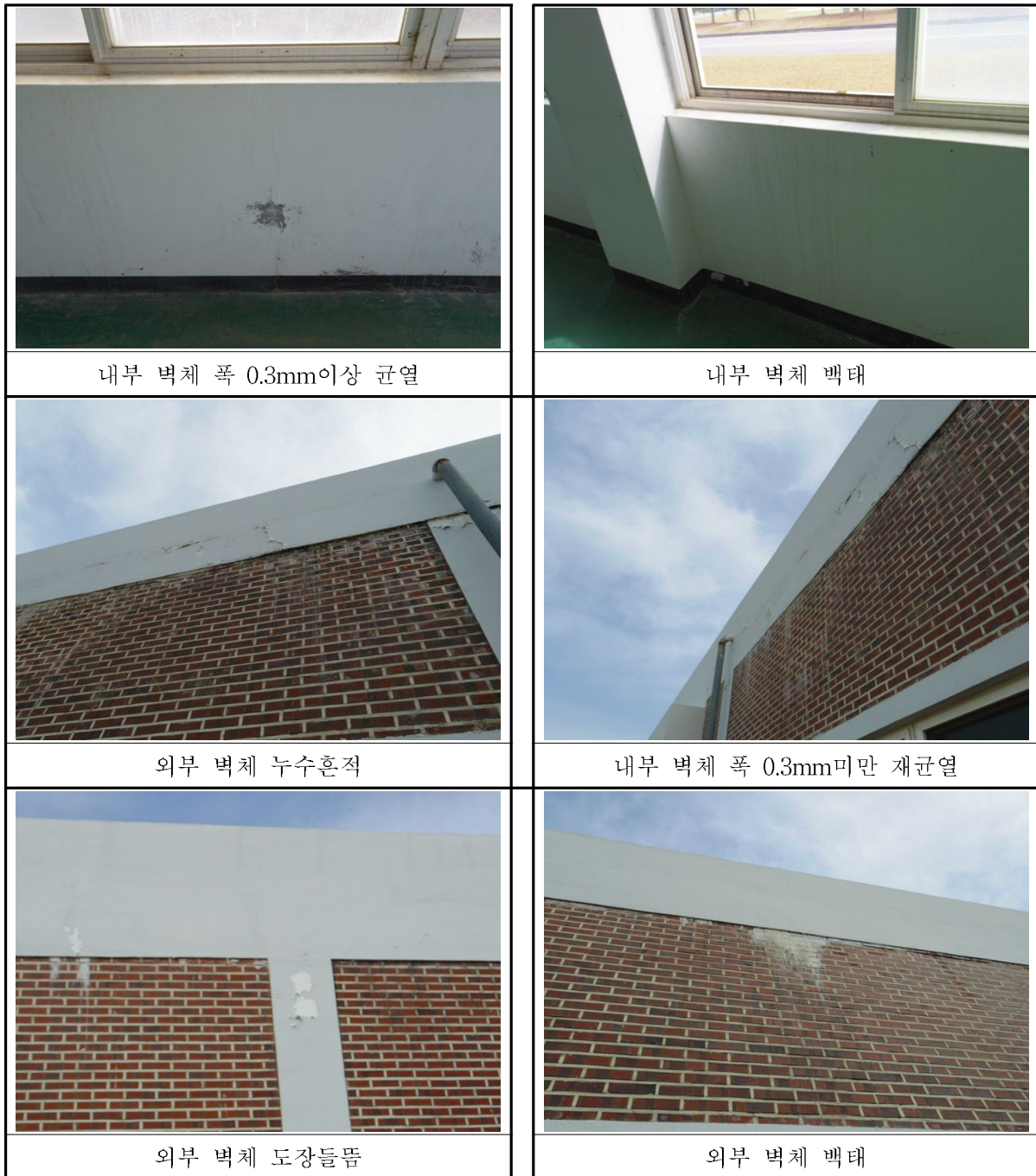
【사진 3.90】 여과지동 손상현황 (계속)
