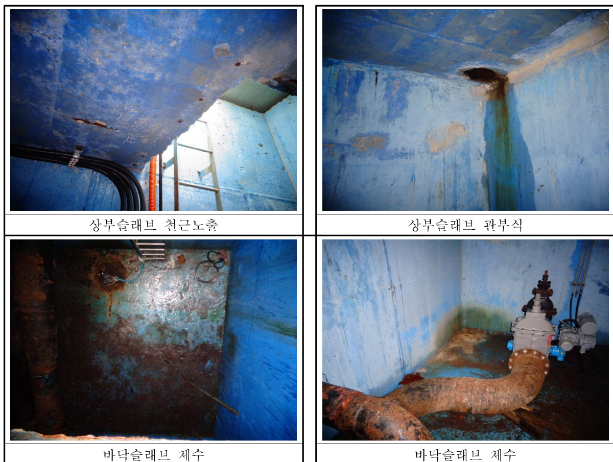
【사진 3.30】 점봉배수지 손상현황
