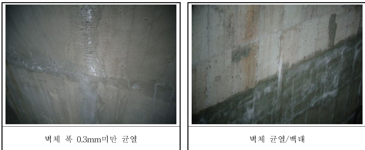
【사진 3.26】 취수펌프장 손상현황
