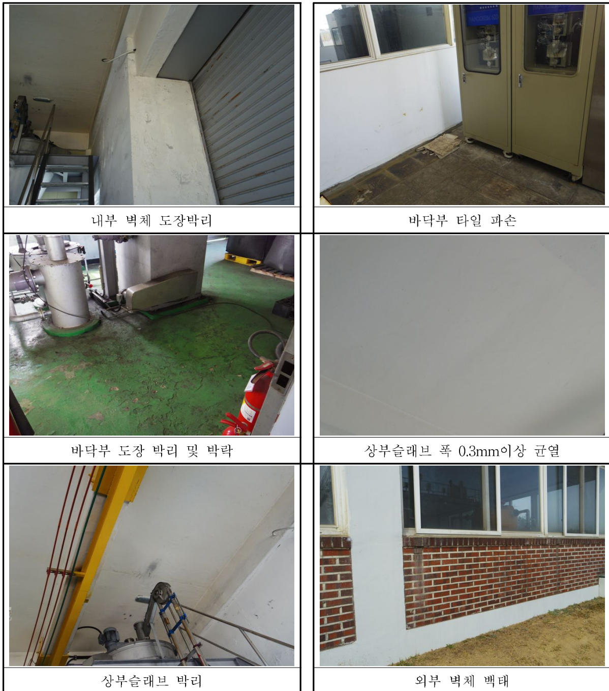
【사진 3.94】 약품투입동 손상현황 (계속)
