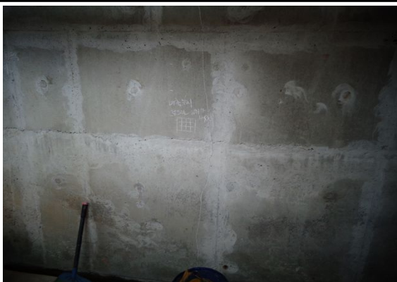
벽체 폭 0.3mm미만 균열
