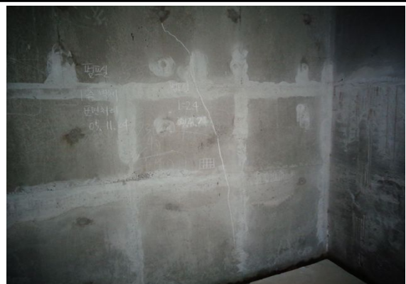
벽체 폭 0.3mm이상 균열
