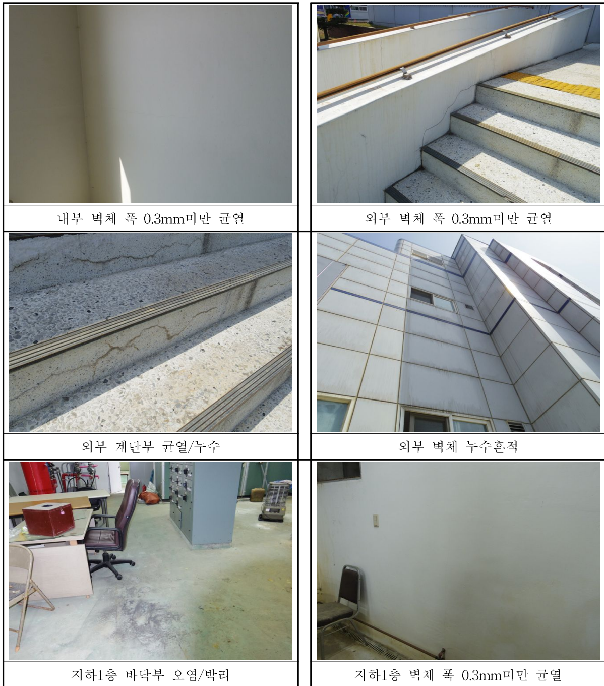
【사진 3.104】 관리본동 손상현황 (계속)
