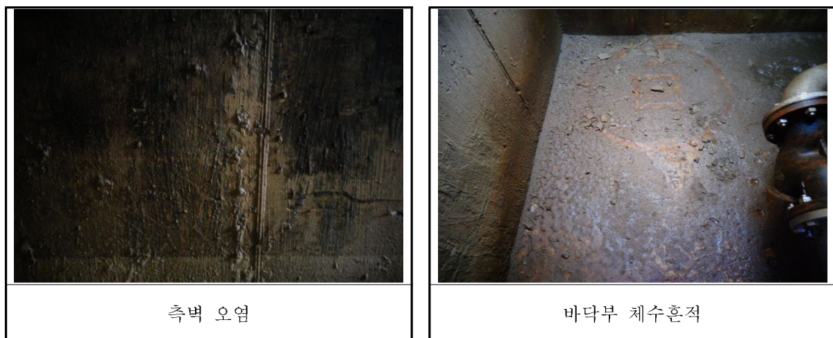
【사진 3.50】 운촌리 가압장 손상현황
