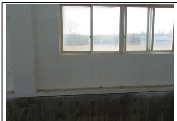
내부 벽체 폭 0.3mm이상 균열
