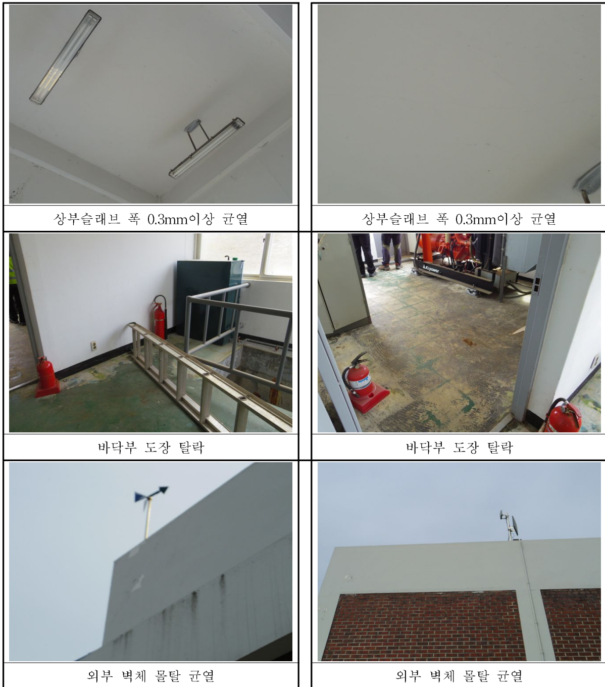
【사진 3.96】 염소투입동 손상현황 (계속)
