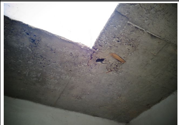
유입밸브실 C 슬래브 재료분리
