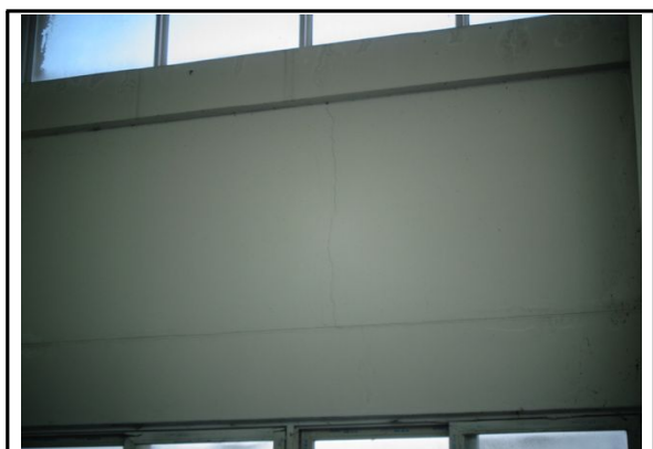
내부 벽체 폭 0.3mm미만 균열
