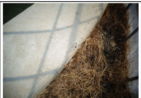
벽체 콘크리트 파손
