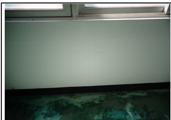
내부 벽체 폭 0.3mm미만 균열
