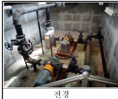
【사진 3.13】 배출수지 전경
